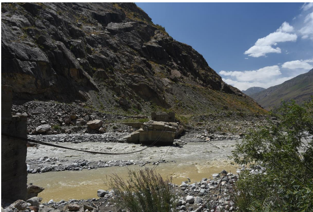
Фото 4. Остатки моста и трос через р. Абдукагор. Вид с правого берега
